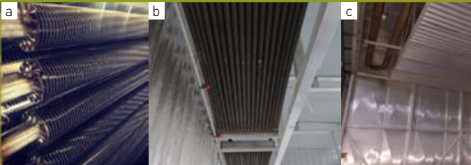
Şekil 23 Kanatlı Boru (a ve b) ve Direkt Yanmalı Brülör (c) Tipi Isıtma Sistemleri
